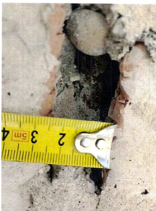
Fot2. Pusta przestrzeń w rejonie żebra stropu Akerman z widocznym prętem ze stali gładkiej.
