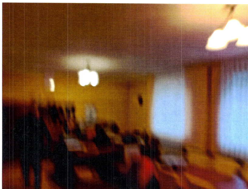
Fot8. Widok sufitu w pomieszczeniu nr104 (zła jakość wykonanego zdjęcia)
